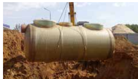
Фото: ГК «Аргель», Argel S - Фильтр сорбционной очистки стоков
